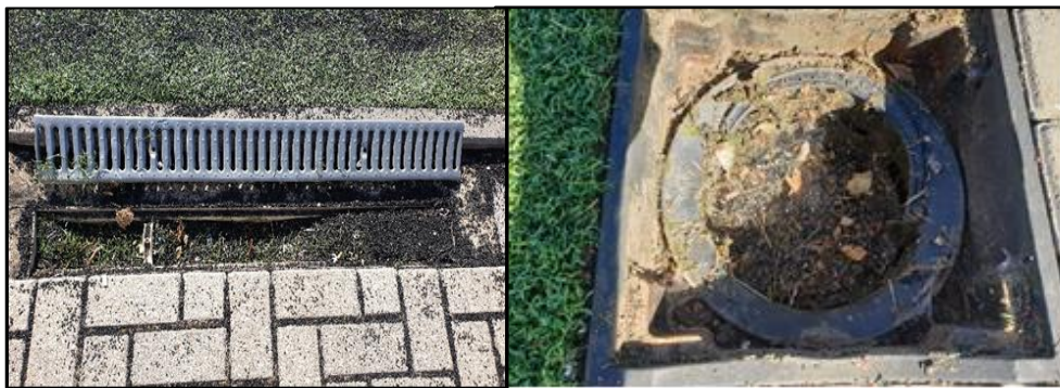
Abbildung 11: verstopfte Abläufe durch fehlende regelmäßige Wartung
