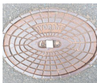
Ein Unterflurhydrant auf der Straße. (Foto: FFW Eppertshausen)
