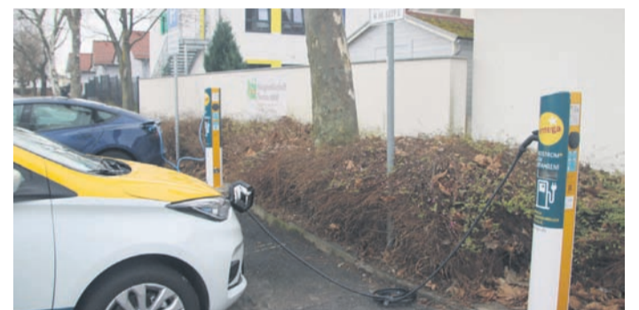
Zwei Fahrzeuge können an einer ENTEGA-Ladesäule gleichzeitig Strom tanken. Auf dem Abtenauer Platz und auf dem Rathausplatz wurde nun jeweils eine zweite Säule installiert. (Foto: Gemeinde Münster)
