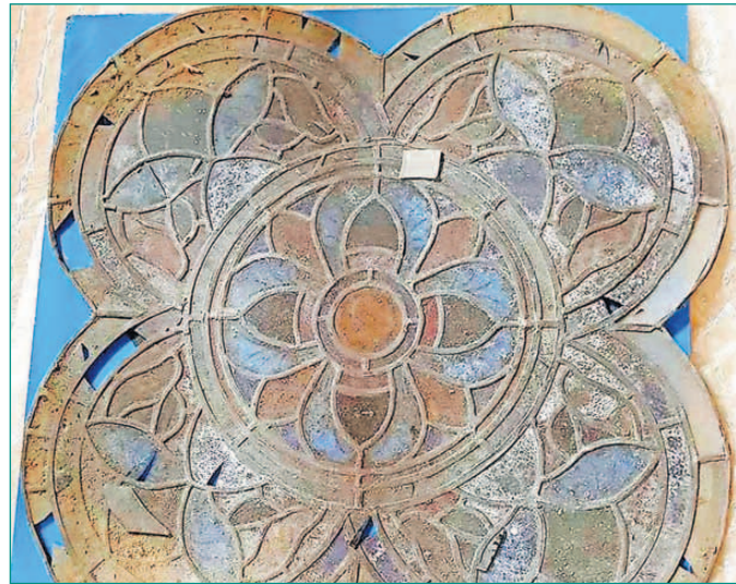
Eines der noch nicht gereinigten und reparierten, historischen Fenster in traditioneller Bleiverglasungstechnik.
