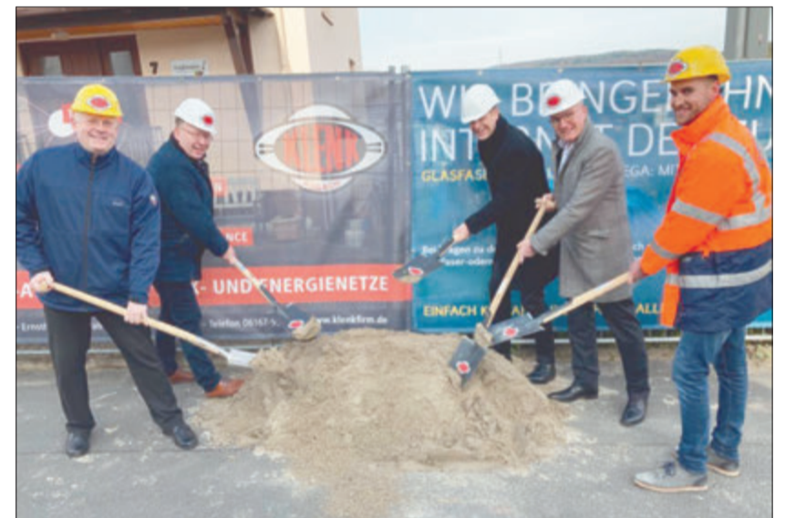
V.l.n.r.: Marius Schwabe (Geschäftsführer OREG), Bürgermeister Axel Muhn, Christoph Busch, Frank Gey (beide ENTEGA Geschäftsführer) und Paul Macke (Geschäftsführer Klenk & Sohn) beim Spatenstich in Bad König. Foto: ENTEGA Plus GmbH
