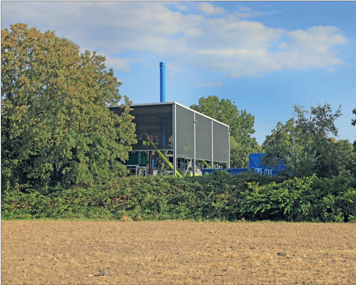
Die neue Karbonisierungsanlage beim EAD in Kranichstein.
