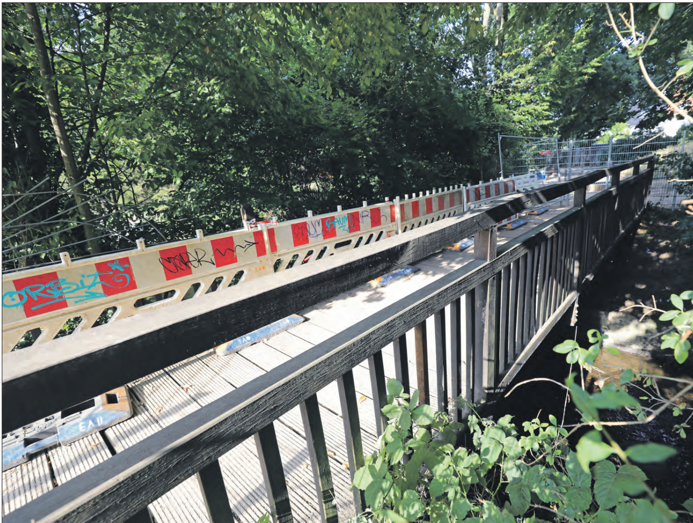
Die gesperrte Brücke an der Modaupromenade.
