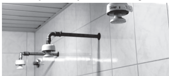
Aus den Duschen im Eppertshäuser Sportzentrum soll auch weiter warmes Wasser kommen. Grund: Das Wasser dort wird mit selbst erzeugter Solarenergie erwärmt.
