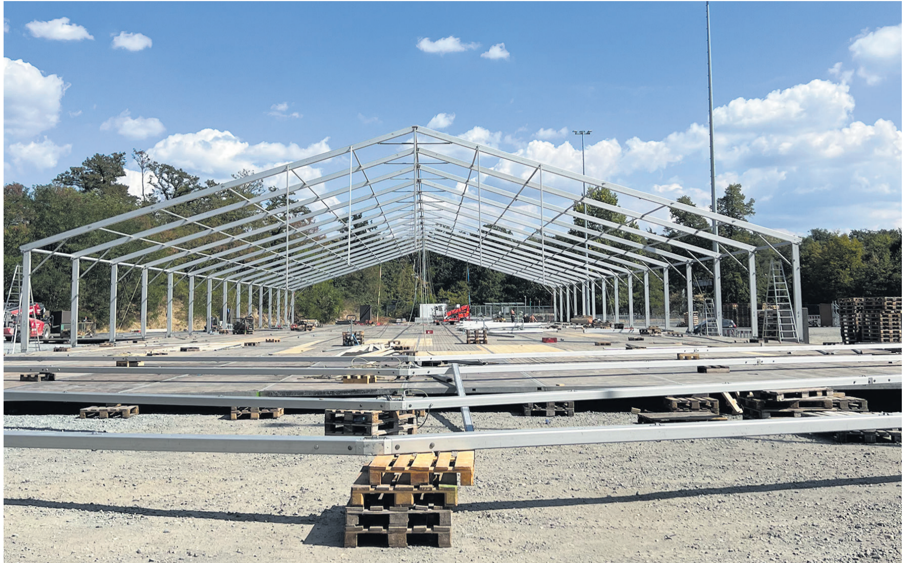
Das Frankfurter Oktoberfest nimmt Gestalt an: Vor dem Gelände des Deutsche Bank Parks finden derzeit die Aufbauarbeiten statt. Vom 7. September bis 3. Oktober werden hier wieder Tausende Besucherinnen und Besucher erwartet. (Foto: No Limit)
