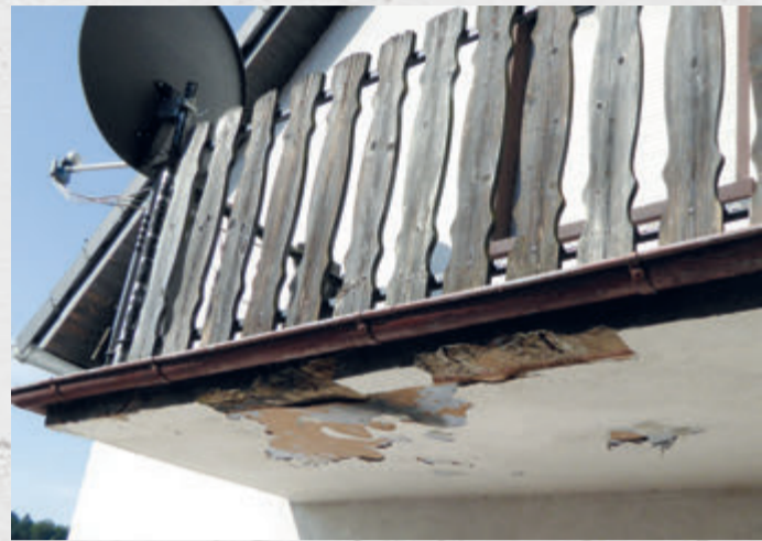
Sind feuchte Stellen oder Abplatzungen an der Unterseite des Balkons zu entdecken, sollten Fachleute zur Prüfung hinzugezogen werden. Foto: Triflex/akz-o
