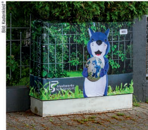
Das Kastenkleid verhüllt den Stromverteilerkasten.
