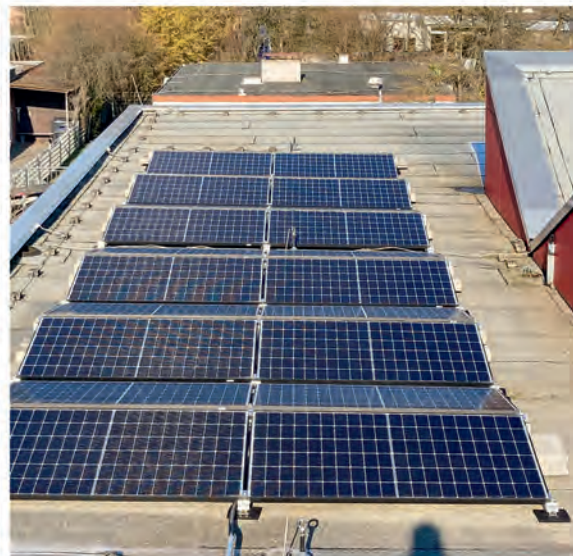
Ein Blick auf die neue PV-Anlage.
