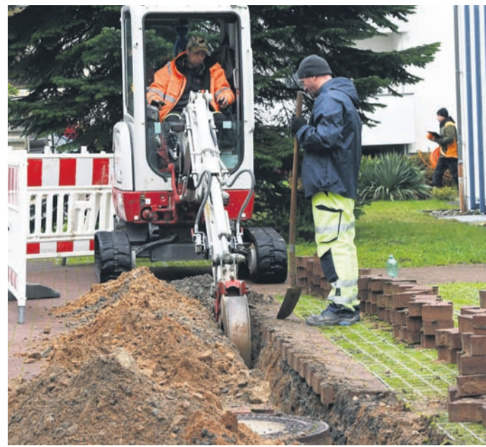
Für den Glasfaser-Ausbau - hier eine aktuelle Baustelle in der Walterstraße - will Münster nächstes Jahr 1,6 Millionen Euro ausgeben. (Foto: jedö)
