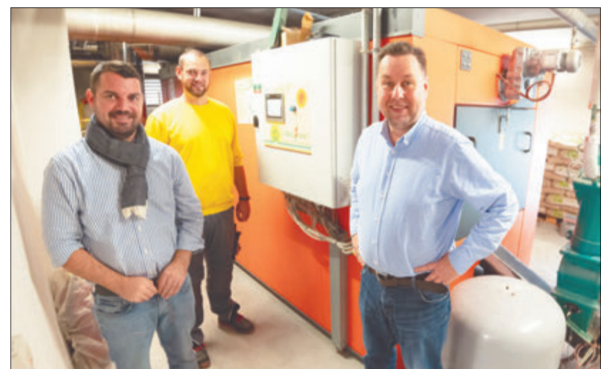
An der Holzpelletanlage der Firma Heizomat aus dem Jahr 2014 haben sich Philipp Vetter, Torben Meyer und Michael Vetter (v.l.n.r.) über die gelungene Umstellung von Holzpellets auf Holzhackschnitteln überzeugt. Foto: Pflegezentrum Odenwald
