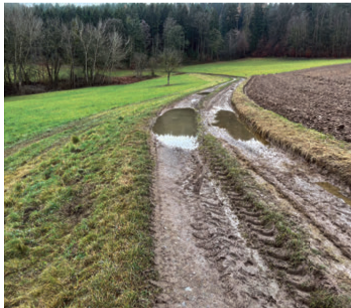
Forstweg Rehbach vor Sanierung.
