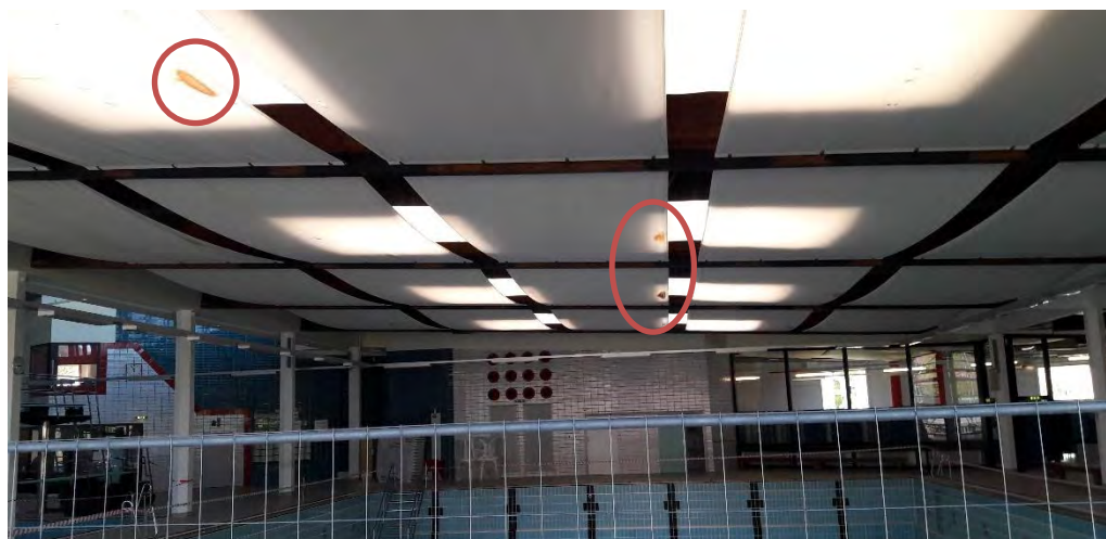
Ansicht 145: Regenschäden an Stoffbahnen aufgrund schadhafter Dachabdichtung an Lichtkuppeln beim Zweckverband Hallenschwimmbad Mittleres Kinzigtal (Aufnahme vom 30. April 2019)
