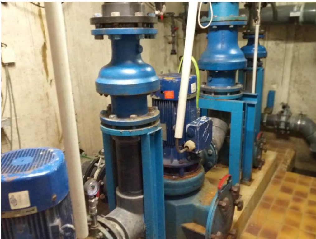
Ansicht 147: Veraltete Pumpentechnik im Freibad Riedstadt Goddelau (Aufnahme vom 22. Mai 2019)
