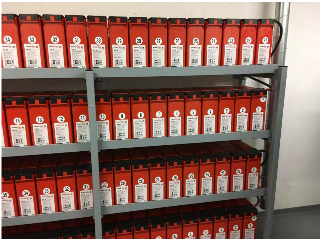
Ansicht 94: Notfallakkumulatorenschrank im Rechenzentrum Kassel (Aufnahme vom 21. Februar 2019)
