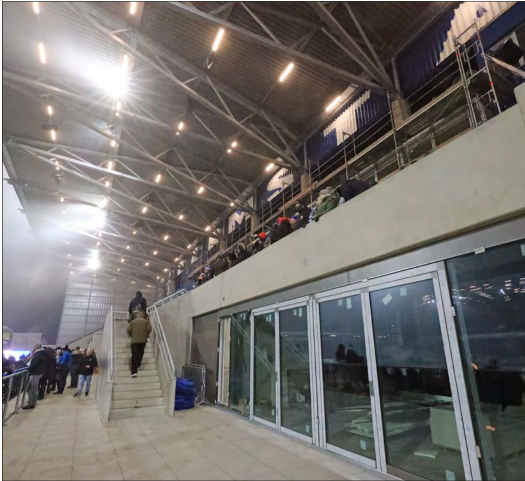
VORSICHT BAUSTELLE: Einige Bereiche der neuen Haupttribüne werden zum Start der Rückrunde noch nicht fertiggestellt sein. (Foto: Arthur Schönbein)
