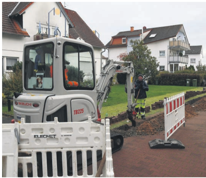
In die Beseitigung weißer Flecken im Glasfasernetz investiert Münster dieses Jahr 1,6 Millionen Euro. Das Foto entstand kürzlich in der Walterstraße.
