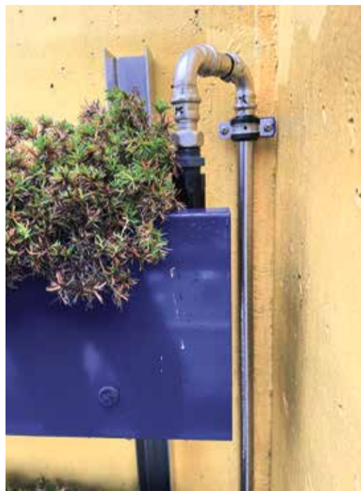
Fassadenbegrünung am MHKW: Fetthenne, Spindelstrauch und andere heimische Gewächse wachsen in Modulen an der Fassade.
