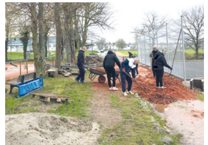
Beim Arbeitseinsatz am vergangenen Samstag packten ebenfalls viele Hände mit an – vor allem bei den Erdarbeiten rund um den neuen Allwetterplatz.
