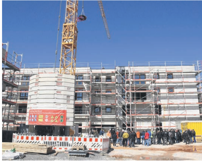
An der Seniorenwohnanlage im Eppertshäuser Baugebiet „Am Abteiwald“ ist Richtfest gefeiert worden. Rund 100 ältere Menschen sollen in den Pflegezimmern und Seniorenwohnungen einmal leben. Im Sommer 2024 könnten die ersten einziehen.
