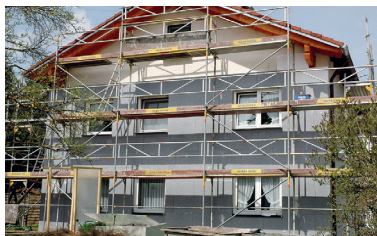
Die Fassadendämmung gehört zu den wesentlichen Maßnahmen, um im Altbau nachhaltig Energie zu sparen. Der Staat unterstützt Modernisierer finanziell. Foto: djd-k/vDPM
