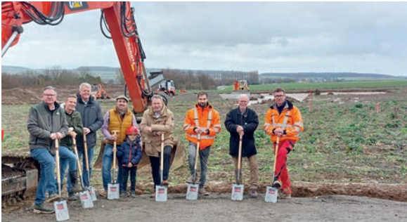
Beim Spatenstich (v.l.): Städtischer Tiefbau-Experte Michael Soborka, Stadtrat Stephan Theiß, Michael Schippers (Terramag), Ortsvorsteher Dennis Vesper nebst Junior, Bürgermeister Guido Rahn, Bauleiter Erik Schmitt, Michael Quentin (Stadtwerke) und Polier Maik Landgraf
