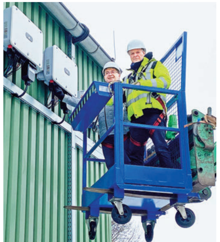
Bürgermeister Achim Grimm (links) und Umweltingenieur Markus Römermann bei der Inbetriebnahme der Photovoltaikanlage. Foto: Gemeinde Groß-Zimmern
