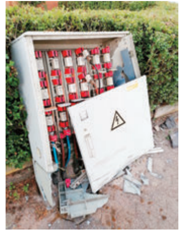
Der Verteilerkasten wurde stark beschädigt, mehrere Anwohner hatten keinen Strom. Foto: Polizei Südhessen
