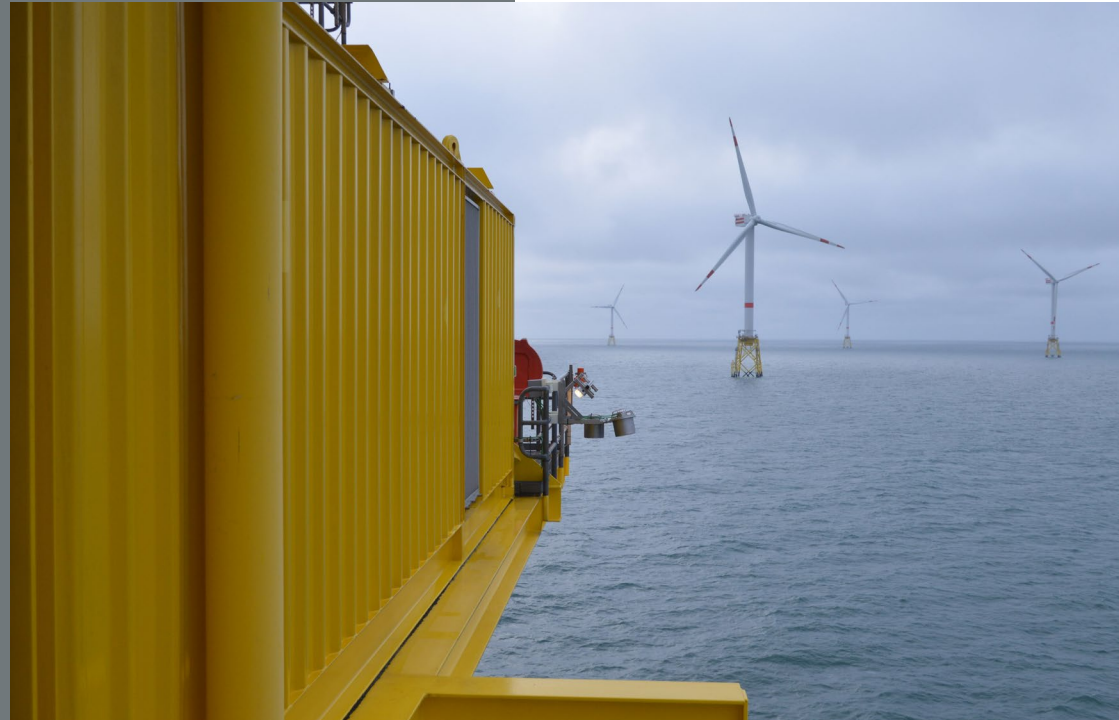
◀ Foto 3.5-2: An der Hälfte der Messstationen finden oder fanden redundante Messungen mit Seegangsboje und Wellenradar statt. Dabei ist das Wellenradar am Umspannwerk des Offshore-Windparks befestigt. Redundante Messungen dienen dem Abgleich der unterschiedlichen Messsysteme und der Verbesserung der Methodik der Datenqualitätskontrolle.
