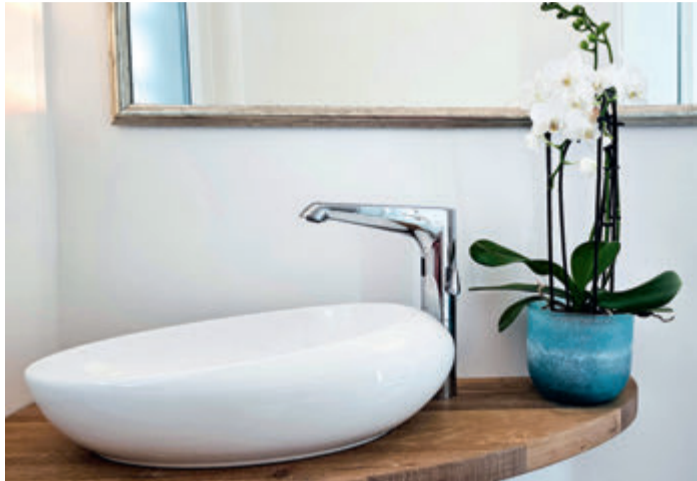
Das „berührungslose“ Waschbecken mit Infrarot-Sensor.
