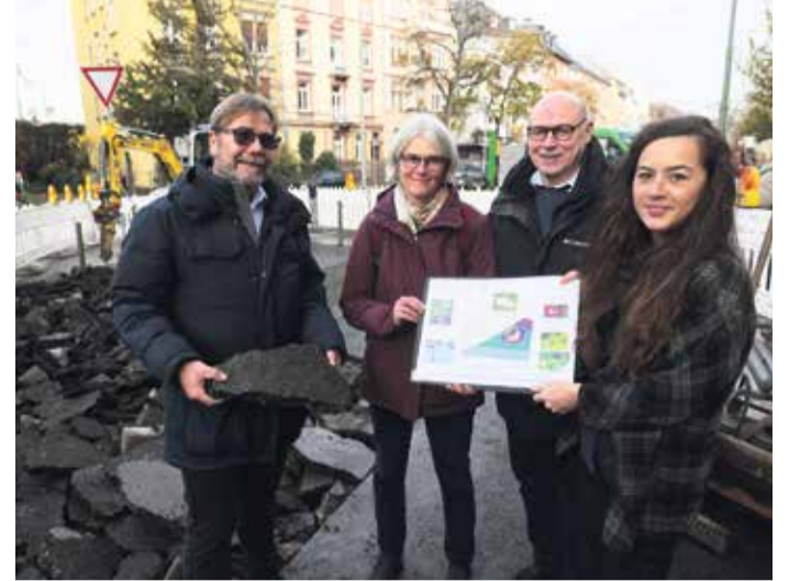
Grau weicht Grün: Im Vordergrund die Projektbeteiligten (v.l.n.r.): Wulfila Walter vom Mobilitätsdezernat, Landschaftsplanerin Elke Blänsdorf, Cary Drud, Mitglied Ortsbeirat 5 und Pate, Marlene Haas, Mitinitiatorin „Green-It-Up“, im Hintergrund aufgestemmter Asphalt, der Platz für ein rund 80 Quadratmeter großes Beet macht, um das sich Patinnen und Paten kümmern werden.
