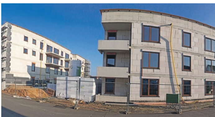
Die Fertigstellung des neuen Seniorenzentrums verschiebt sich um sechs bis neun Monate und ist nun für Ende 2024 geplant.
