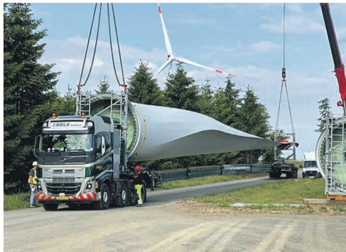
Anlieferung eines Rotorblatts mit Spezial-Lkw am ENTEGA-Windpark Binselberg bei Groß-Umstadt. (Fotos: ENTEGA)
