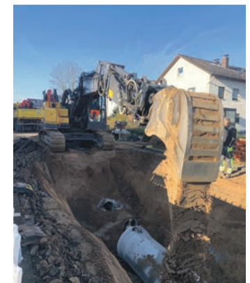
Einblicke unter die Friedrich-Ebert-Straße: Aktuell wird im Bereich zwischen Schillerstraße und Walterstraße gearbeitet. (Foto: GM/Meike Mittmeyer-Riehl)
