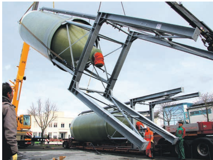
Betriebschaffmeister Thorsten Heberer an der stahlverzinkten Trägerkonstruktion, auf der die neuen Silos ruhen. (Foto: Stadt Rödermark)
