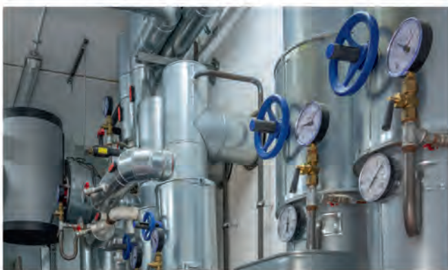
Aufwendige Technik in der Wärmezentrale.
