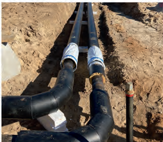
Die Fernwärmeleitung im Stadtquartier Süd.
