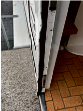
Die Tür wurde stark in Mitleidenschaft gezogen.
