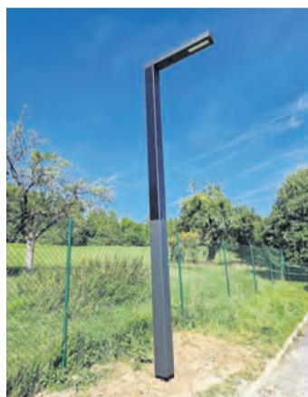
Eine der neuen Lampen.
