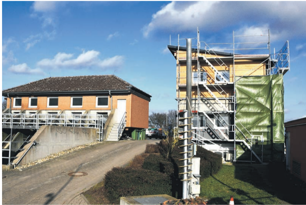
Das neue Betriebsgebäude der Münsterer Kläranlage wächst zusehends. Es zählt zu den aktuell größten Investitionen der Gemeinde. (Foto: jedö)
