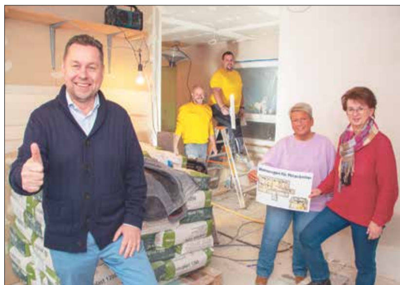
Geschäftsführer Michael Vetter (l.) besichtigt die umfangreichen Arbeiten bei der Sanierung der Wohnungen für Pflegefachkräfte mit Pflegedienstleiterin Stationäre Pflege Angela Scheil und Pflegedienstleiterin Ambulante Pflege Melanie Trautmann. Marco Müller und Sascha Siefert von der Haustechnik haben tatkräftig in einer Wohnung Verputzearbeiten durchgeführt. Foto: Pflegezentrum Odenwald.
