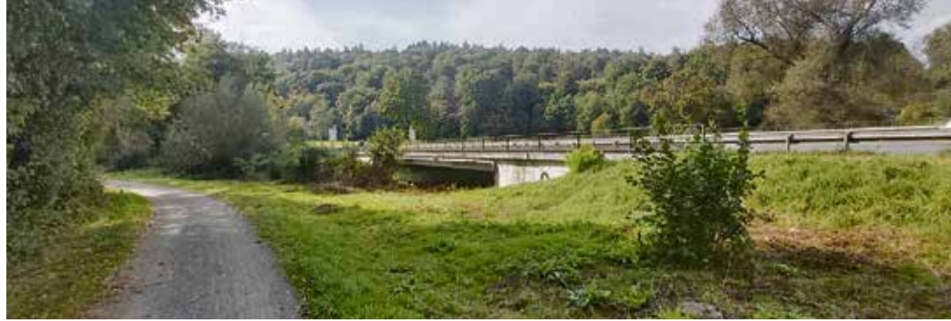
Die Brücke muss abgerissen und neu gebaut werden. Die Behelfsumfahrung wird das Strauchwerk gerodet. Foto: Hessen Mobil
