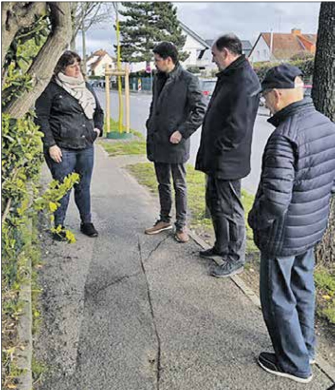
Risse im Asphalt.
