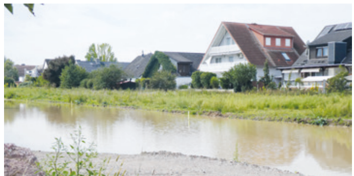
Baugrube in den Viernmorgen nach dem Starkregen.
