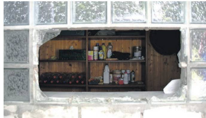
Auch in die „Fischerhütte“ am Bitzensee drangen Einbrecher ein. Dabei zerschlugen sie diese Glasbausteine.
