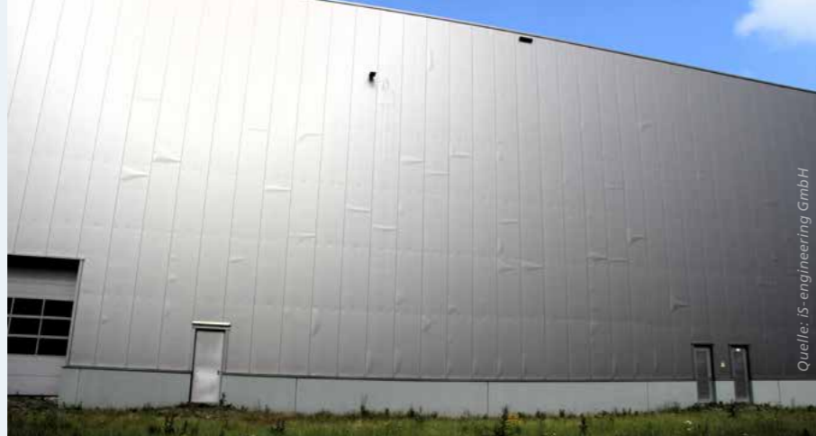
Phänomen der Blasenbildung an einer Fassade, die mit Reklamationen und Nachproduktion verbunden ist.
