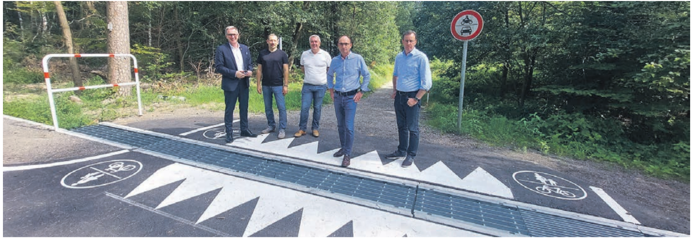
Die Amphibientunnel sind fertig und die Querungen sowie Markierungen für Fußgängerinnen und Fußgänger sowie Radfahrende sind angebracht. V.l.: Bürgermeister Steffen Ball, Günter Gaiser (Kreis Offenbach, Untere Naturschutzbehörde), Bernd Dillmann (Allegron/Campus Heusenstamm), Fachdienstleiter Tiefbau Thomas Möller und Kreisbeigeordneter Alexander Böhn. (Foto: R. Dinkelborg/Magistrat)
