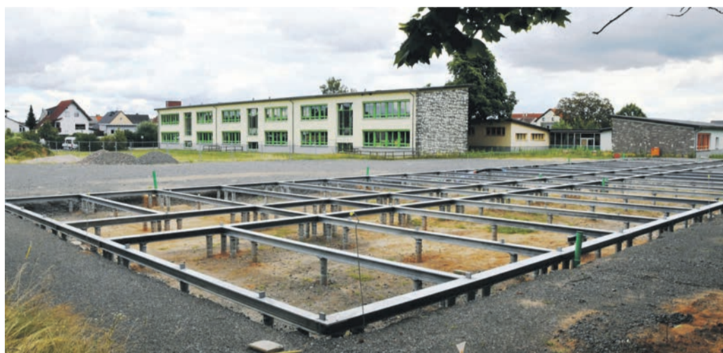
Die Schraubfundamente sind zwar montiert, doch die weitere Errichtung des 12,5-Millionen-Neubaus an der Münsterer Kennedy-Schule stockt. Er soll nun erst nach den Weihnachtsferien fertig werden. (Foto: jedö)
