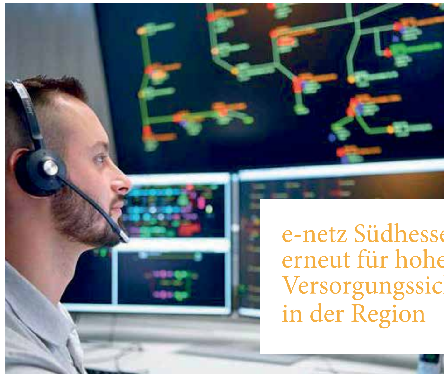
Schaltmeister in der zentralen Leitwarte der E-Netz Südhessen in Darmstadt. Foto: E-Netz
