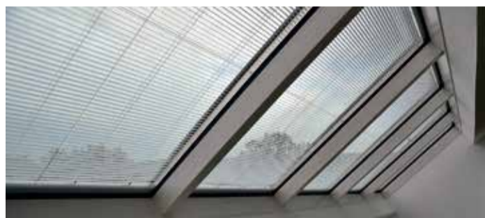
Gerade in Dachwohnungen kann sich die Hitze stauen – eine effiziente Lösung verhilft zu kühlem Wohnraum.
