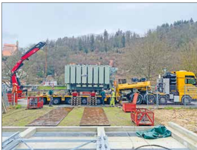
Ein Spezial-Schwertransport brachte den Transformator über die kurve und teilweise beengte Strecke sicher ans Ziel.
