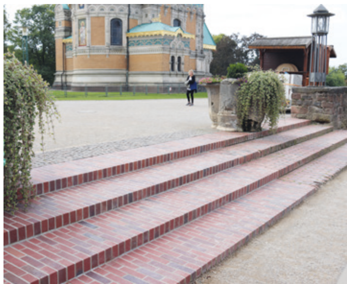
Nicht nur hier fehlen am breiten Aufgang am Sabaisplatz Handläufe.
