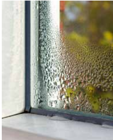
Feuchtigkeit in der Wohnung und als Ergebnis ein erhöhter Energiebedarf: Ein Austausch alter Dichtungsprofile ist dann oftmals unerlässlich.
