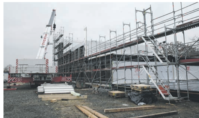
Für 12,5 Millionen Euro erhält die Münsterer Kennedy-Schule derzeit einen dreigeschossigen und aus Holzmodulen bestehenden Neubau mit zwölf Klassenräumen, vier Differenzierungsräumen, zwei „Teamstationen“ sowie neuen Verwaltungsbüros. Nach den Osterferien soll er bezugsfertig sein.
